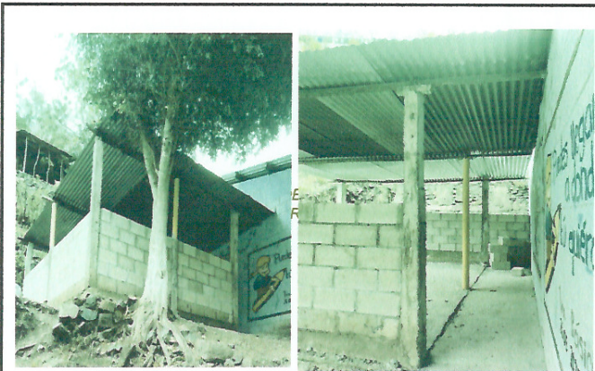
Foto 1: Se prioriza el mejoramiento de techo de estructura metalica tipo portico con láminas troqueladas calibre 26, mejoramiento de pared, ventanas, balcones, piso tipo granito o cerámico y puerta de metal.
