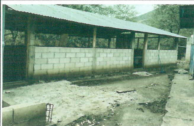
Foto 3: Se prioriza el mejoramiento de una losa de patio con cuneta de concreto
